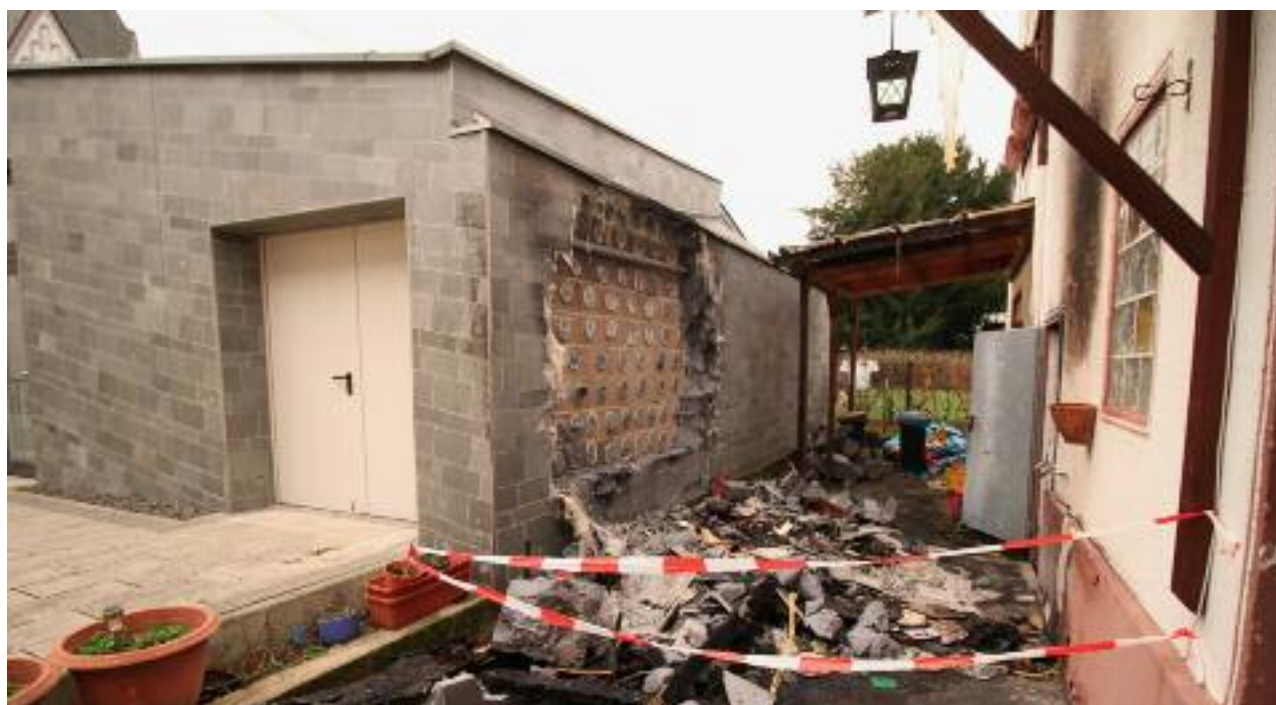
Dem schnellen Einsatz der Feuerwehr war es zu danken, dass nicht noch mehr Schaden entstanden ist. Die Reparaturkosten werden
